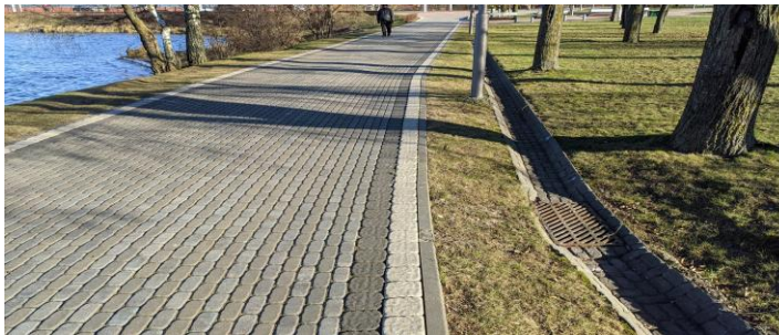
Рис. 4.8. Дождеприемники в благоустроенной пешеходной зоне парка
